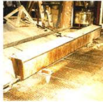
Hinweis: Tauchbehälter ist geeerdet!
