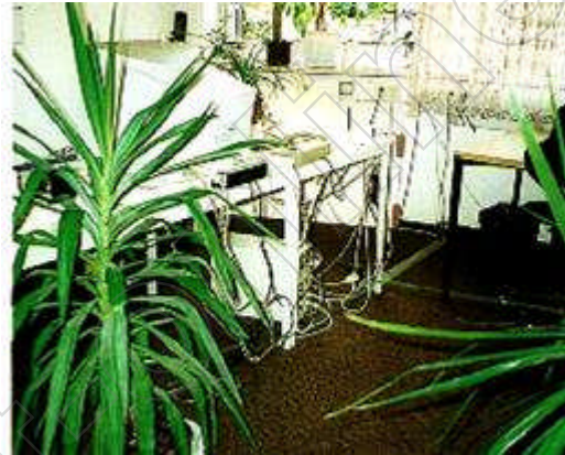
Bild 8-3: Beispiel für Kabelabdeckung und fehlende Kabelkanäle (lose hängende Kabel)
