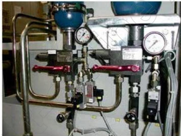
Bild 25: Druckentlastete Hydrospeicher mit abgesperrten Druckleitungen
