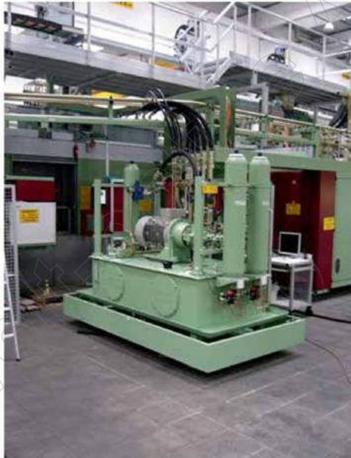
Bild 24: Hydraulikaggregat an stationärer Produktionseinrichtung
