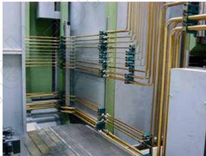
Bild 10: Fachgerechte Befestigung von Rohrleitungen mit Rohrschellen
