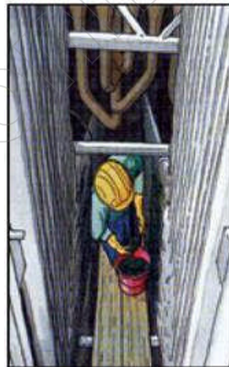
Abbildung 3: Kontrolltätigkeiten (Hineinbeugen): nur mit zusätzlichen Schutzmaßnahmen möglich, hier: ein Schutzgitter im Mannloch, welches ein Hineinstürzen verhindert.
