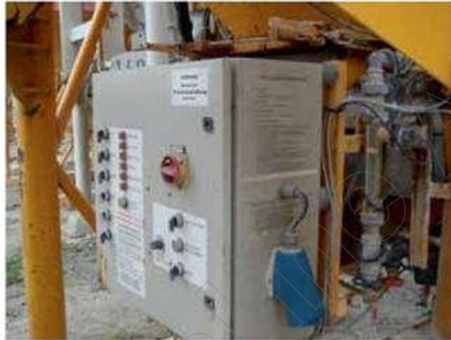
Bild 5 : Steuereinheit mit Hauptschalter und Hinweisen zum sicheren Betrieb.
