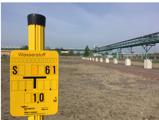
Abbildung 1 – Hinweisschild erdverlegte Wasserstoffleitung
