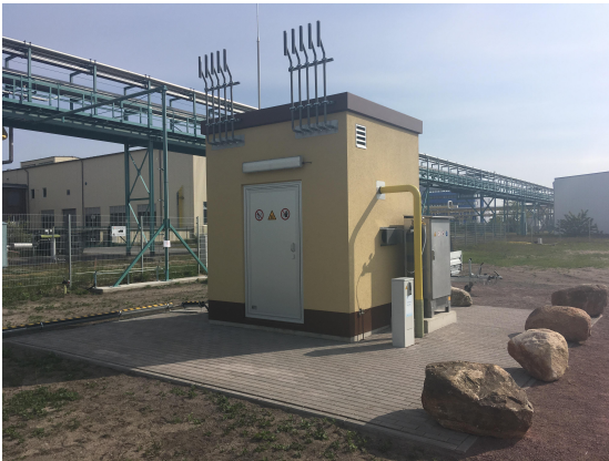
Abbildung 2 – Gas-Druckregel- und Messanlage
