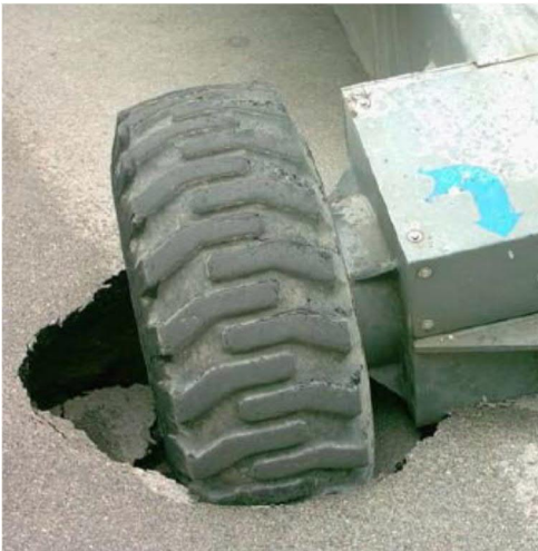
Bild 3: Eingebrochenes Rad einer FHAB aufgrund eines Hohlraumes
