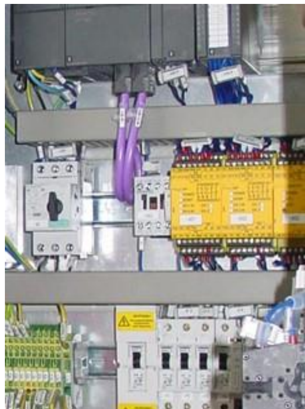
Abbildung 1 – Elektrische Ausrüstung einer Maschine
