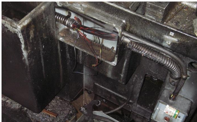
Bild 4: Angeschmorte freiliegende Kabel
