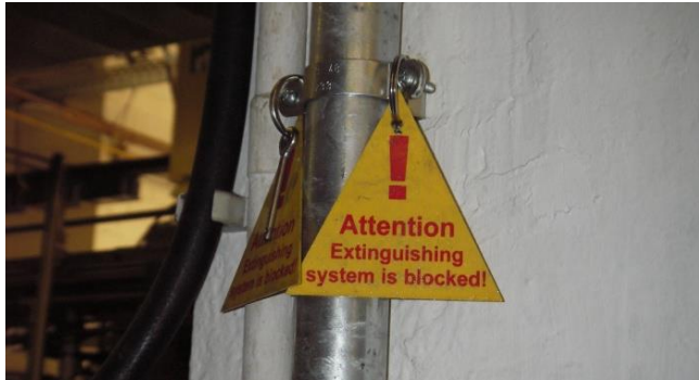
Bild 3: Blockieren der Löschanlage
