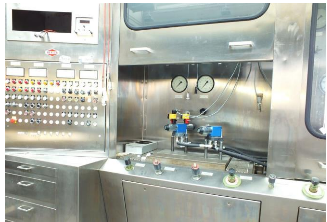
Bild 3: Hydraulischer Komponentenprüfstand mit geöffneter trennender Schutzeinrichtung
