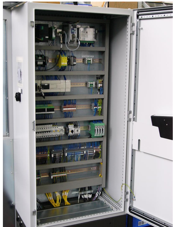
Bild 11: Geöffneter Schaltschrank eines Prüfstands
