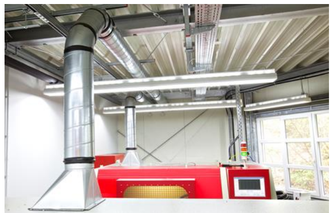
Bild 12: Absaugung an Prüfständen
