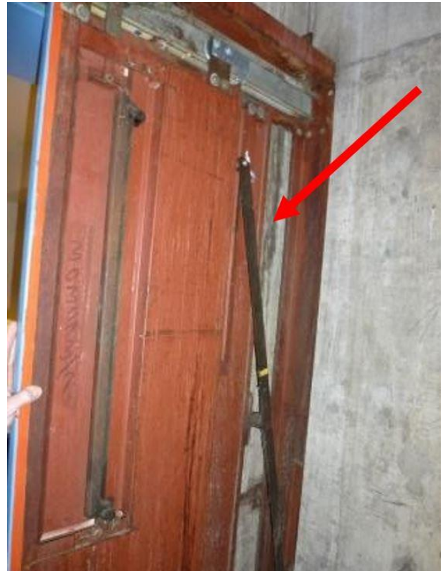
Abbildung 21 – Asbesthaltige Leichtbauplatte bzw. asbesthaltige Pappe zwischen den Türwandungen
