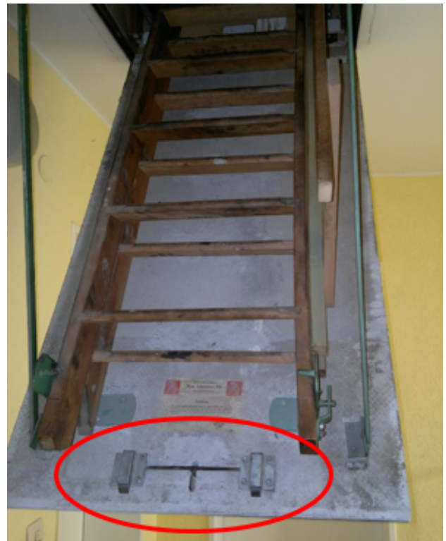
Abbildung 5 – Einschubtreppe als Zugang zum Triebwerksraum mit Abriebspuren durch die Benutzung an der Asbestplatte des Lukendeckels
