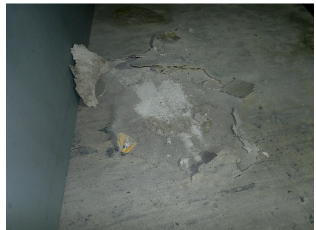
Abbildung 18 – Asbesthaltiger Rücken des Bodenbelags
