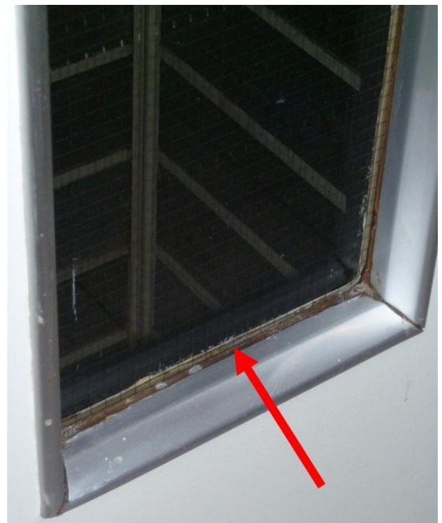
Abbildung 22 – Asbesthaltige Dichtung an Türverglasung
