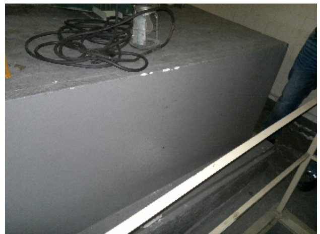
Abbildung 9 – Mit Farbe überstrichene asbesthaltige Leichtbauplatten als Abdeckung
