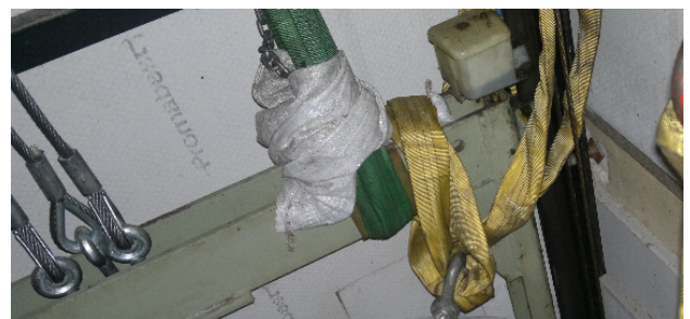
Abbildung 10 – Asbesthaltige Leichtbauplatten als Schachtverkleidung
