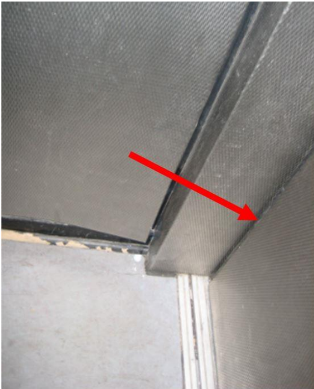
Abbildung 19 – Asbestzementplatten hinter der Kabinenverkleidung (im Bild nicht sichtbar)
