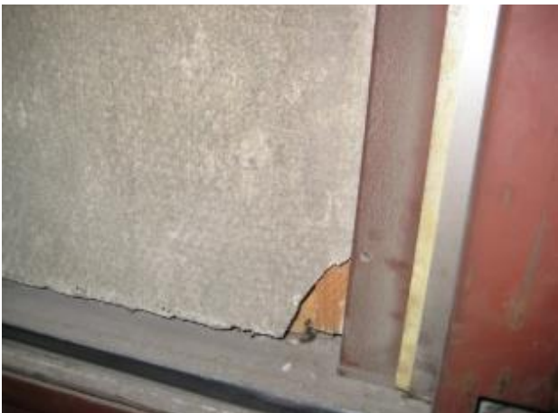
Abbildung 7 – Asbestzementplatten als Wandverkleidung
