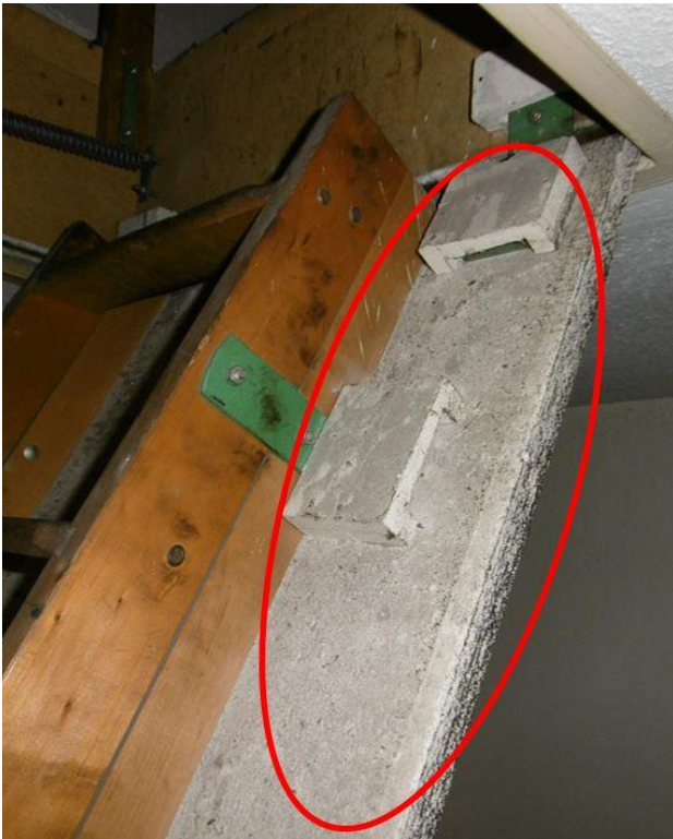
Abbildung 3 – Mit asbesthaltiger Leichtbauplatte beplankter Lukendeckel zum Triebwerksraum
