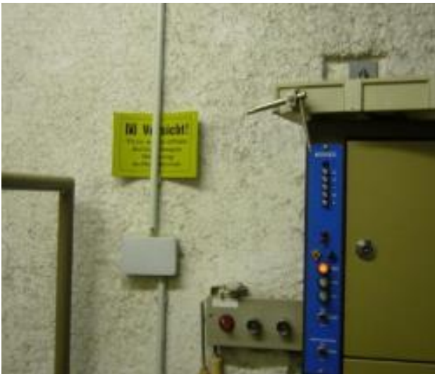
Abbildung 6 – Mit Spritzasbest beschichtete Wand in einem Triebwerksraum
