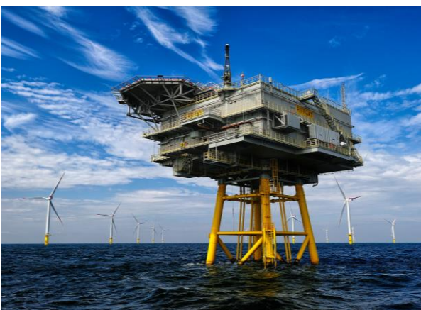
Bild 1: Riffgat EWE Umspannstation
