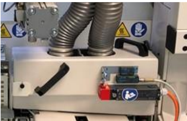
Abbildung 6 – Beispiel einer zugehaltenen Schutzeinrichtung an einem Vorfräs-/Fügeaggregat
