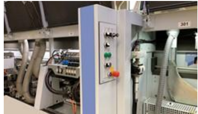
Abbildung 3 – Beispiel von Befehlseinrichtungen auf einem zusätzlichen Bedienpult
