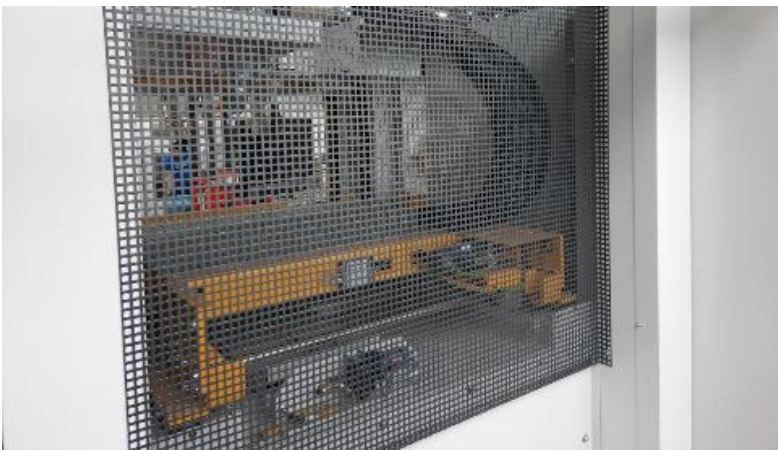
Bild 1: Fest installierte trennende Schutzeinrichtung im rückwärtigen Bereich der Warmformmaschine
