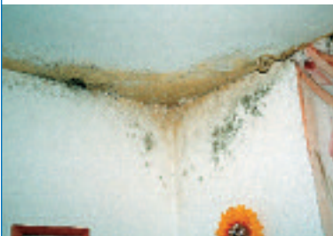
Bild 4: Schimmelpilzbefall undichtes Flachdach
