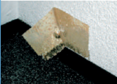
Bild 3: Schimmelpilzbefall unter der Tapete
