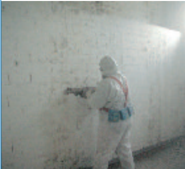
Bild 5: Beispiel für starke Sporenexposition (Gefährdungsklasse 3) beim Abschlagen von Putz ohne Absaugung
