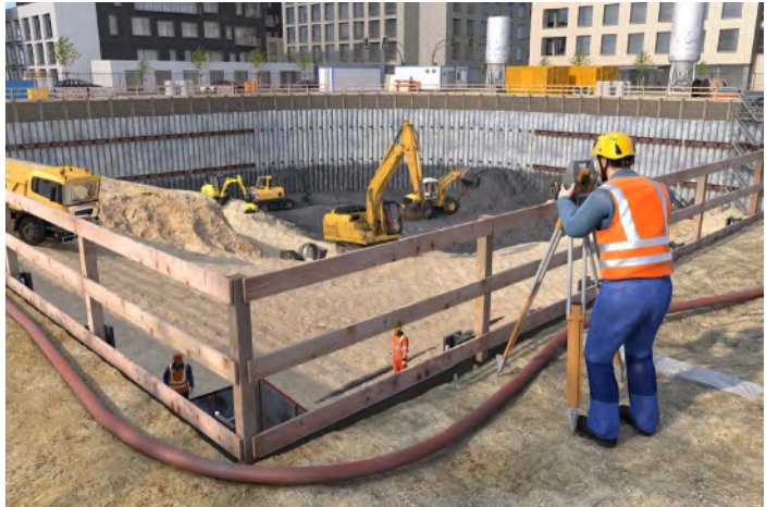
Abb. 22 Dreiteiliger Seitenschutz als Absturzsicherung
