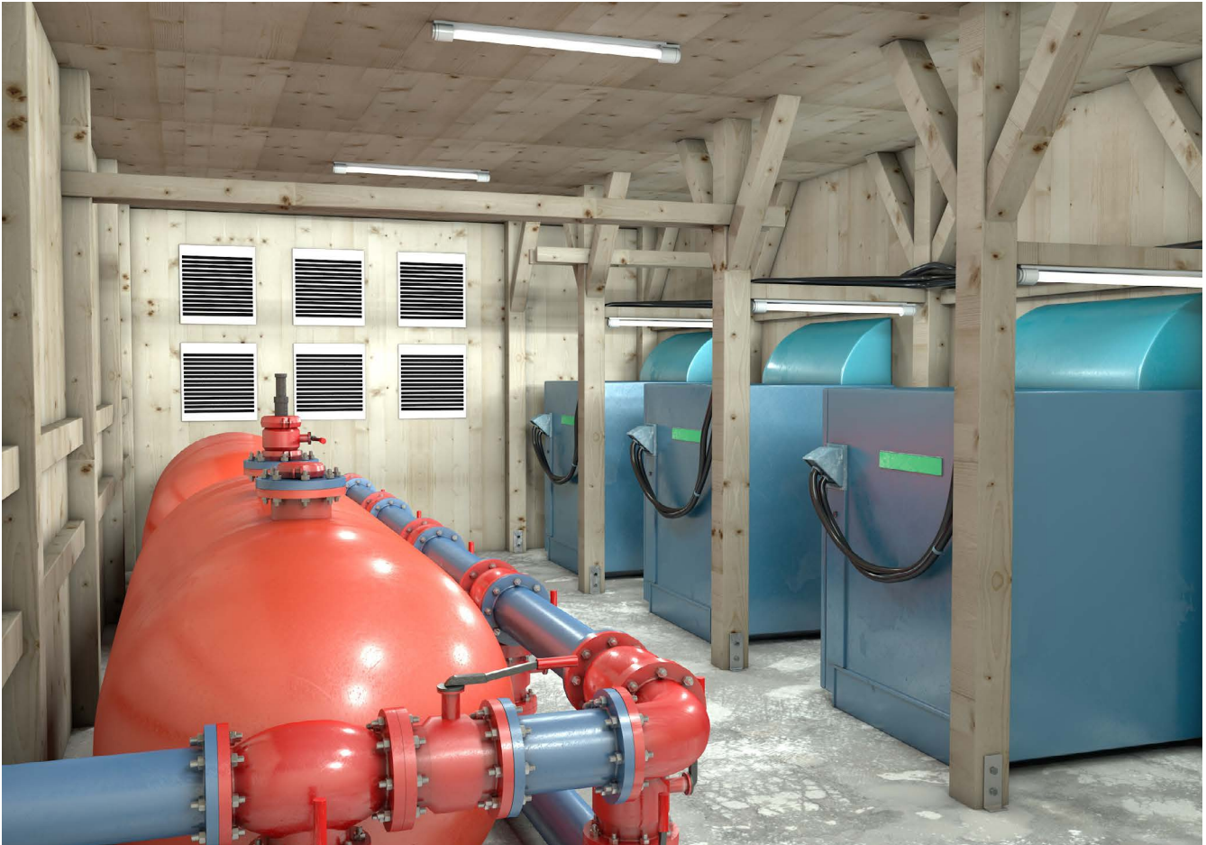
Abb. 1 Vor Sonneneinstrahlung geschützte Kompressoranlage und Druckbehälter
