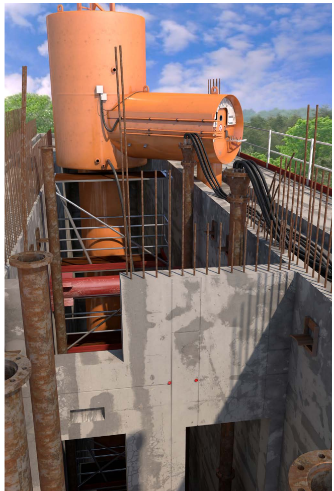
Abb. 13 Personenschleuse und vertikales Schachtröhre eines Senkkastens
