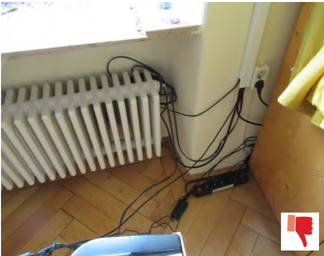
Abb. 2 Negatives Beispiel: Kabel, die hinter Heizkörpern verstaut sind, werden (hohen) Temperaturschwankungen ausgesetzt und ihre Ummantelung kann dadurch spröde und rissig werden. Zudem stellen die Kabel Stolperfallen dar.
