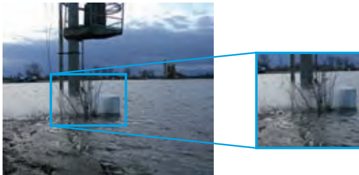
Dampfender Kabelverteilerschrank im Wasser
