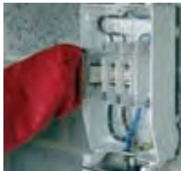
Hausanschlusskasten mit Niederspannungs-Hochleistungssicherungen (NH-Sicherungen)
