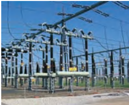
Leistungsschalter in einem 380 kV-Schaltfeld
