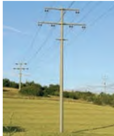
Masthöhe ca. 10 – 16 m 20 kV-Doppelleitung
