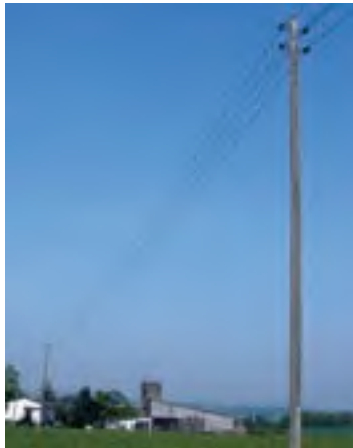
Masthöhe ca. 8 – 12 m Niederspannungsfreileitung
