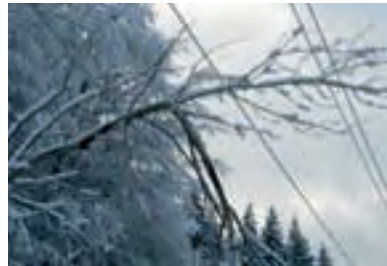
Äste in 110 kV-Freileitung
