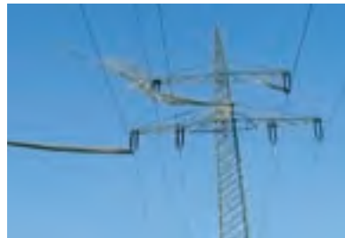
„Spargelfolie“ in 110 kV-Freileitung
