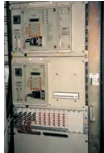
Netzschutz moderne digitale Ausführung
