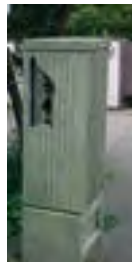
Beschädigter Kabelverteiler- schrank
