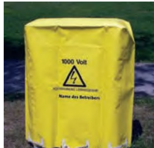
Beschädigter Kabelverteilerschrank isolierend abgedeckt
