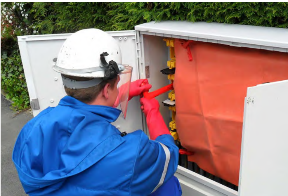
Abb. A 6-2 Wechsel einer Sicherungsleiste im Schaltschrank (nahe der Seitenwand): k_T = 1,0
