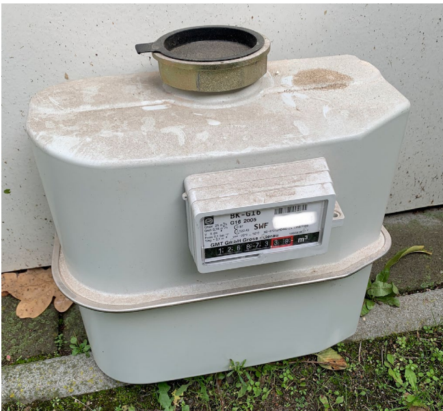
Abb. 42 Verschluss ausgebauter Gaszähler
