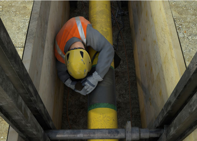
Abb. 13 Verwendung elektrischer Betriebsmittel in einer engen Baugrube
