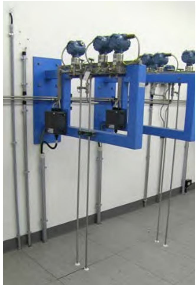
Abb. 41 Messumformerraum mit aufgeständertem Plattensystem-Fußboden (ableitfähig)
