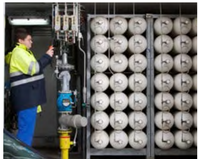
Abb. 17 Speicherflaschen in einer Erdgastankstelle
