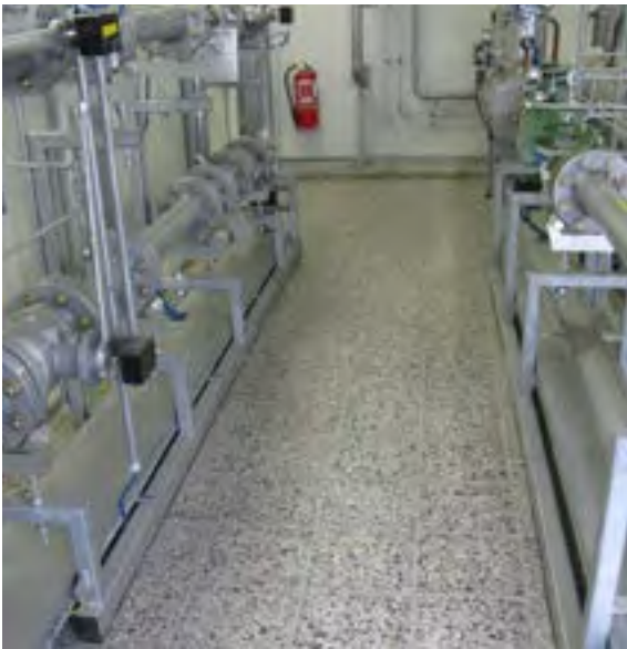
Abb. 33 Aufstellungsraum einer GDRM-Anlage mit ableitfähigem Fußboden
