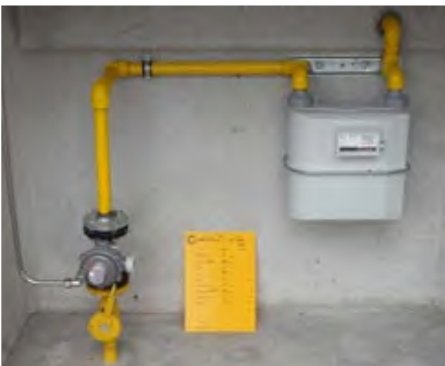
Abb. 16 Gas-Druckregelung im Netzanschluss
