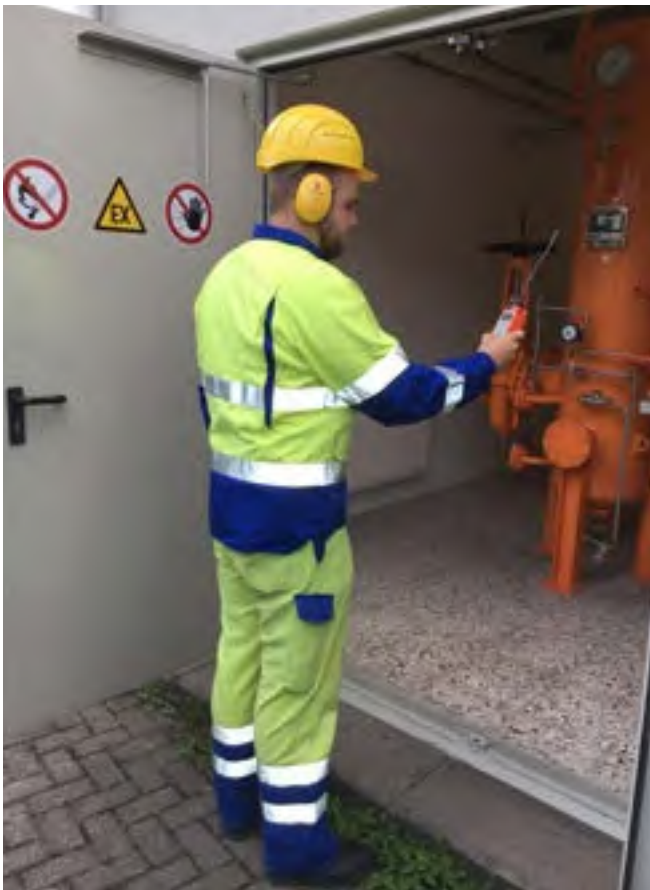
Abb. 12 Arbeitsplatzüberwachung mit einem tragbaren Gaswarngerät
