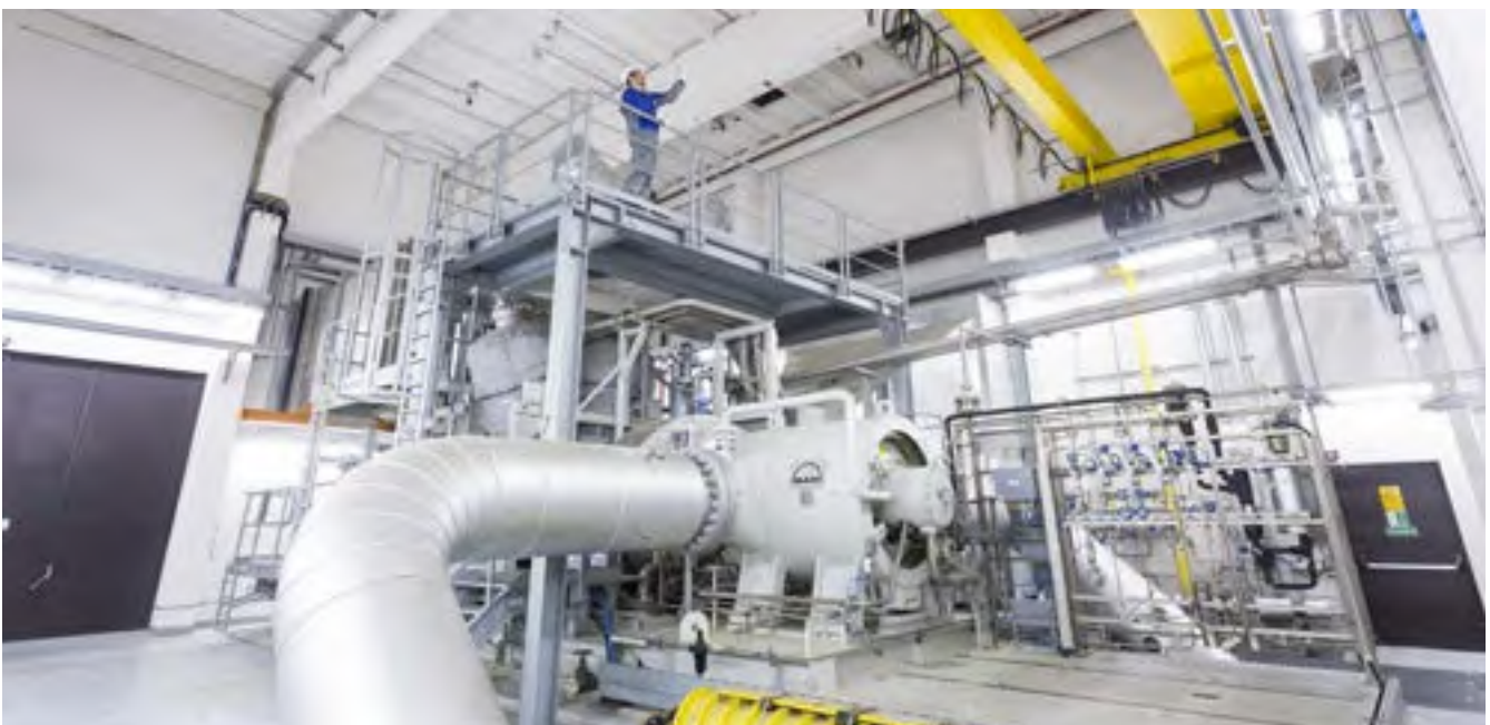
Abb. 5 Krananlage in einer Gas-Verdichteranlage
