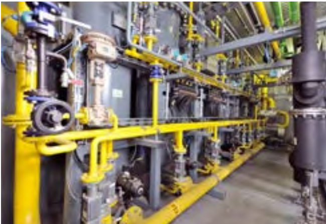
Abb. 18 Gasleitungen im Bereich einer Biogasaufbereitungsanlage
