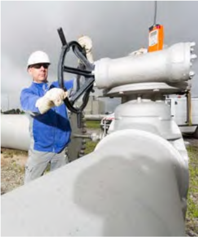
Abb. 9 Schließen einer Absperrarmatur
