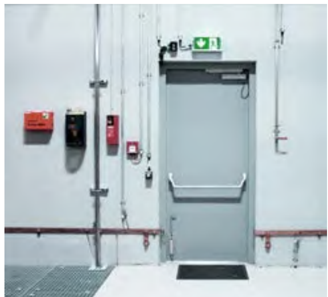
Abb. 4 Kennzeichnung eines Fluchtweges
