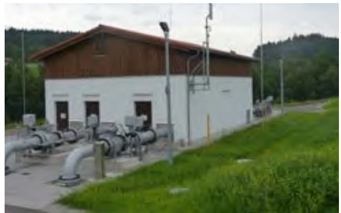
Abb. 29 GDRM-Anlage mit Abblase- und Entspannungsleitung
