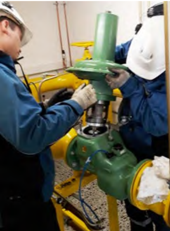
Abb. 11 Wartung eines Regelgerätes
