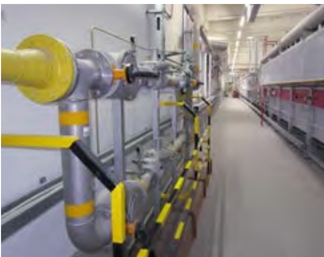
Abb. 24 Sicherheits- und Regelstrecke (Gasstrecke) an einer Thermoprossanlage
