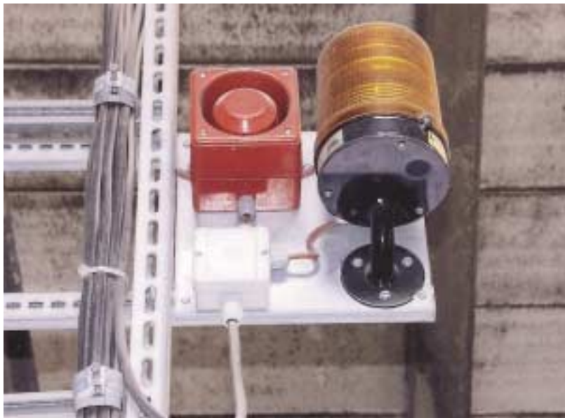
Abb. 20: Akustische und optische Anlaufwarneinrichtung
