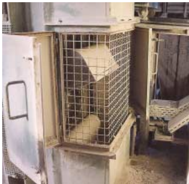
Abb. 39: Schutzgitter an einer Schauöffnung
