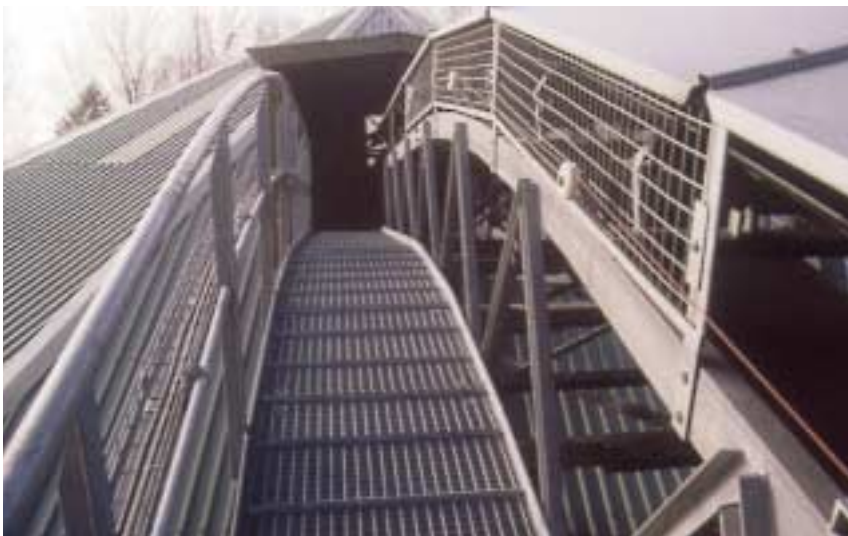
Abb. 15: Seitliches Schutzgitter an einer Bandabknickung
