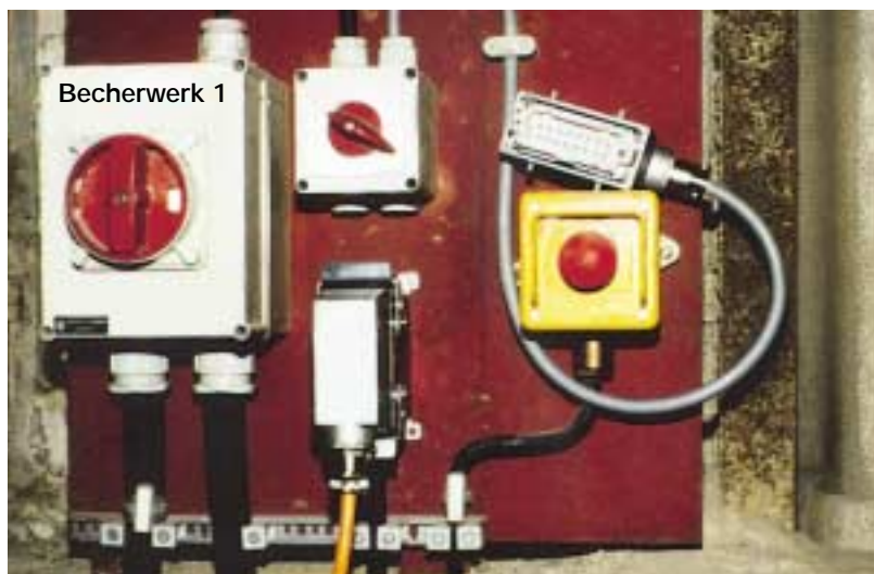
Abb. 40: Vor-Ort-Schalteinrichtung an einem Becherwerk
