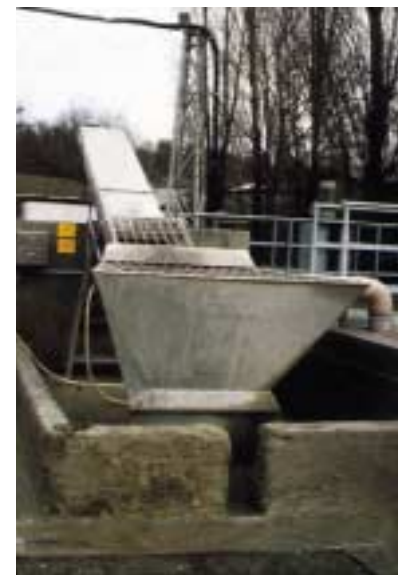
Abb. 42: Recycling-Anlage mit Austragsschnecke
