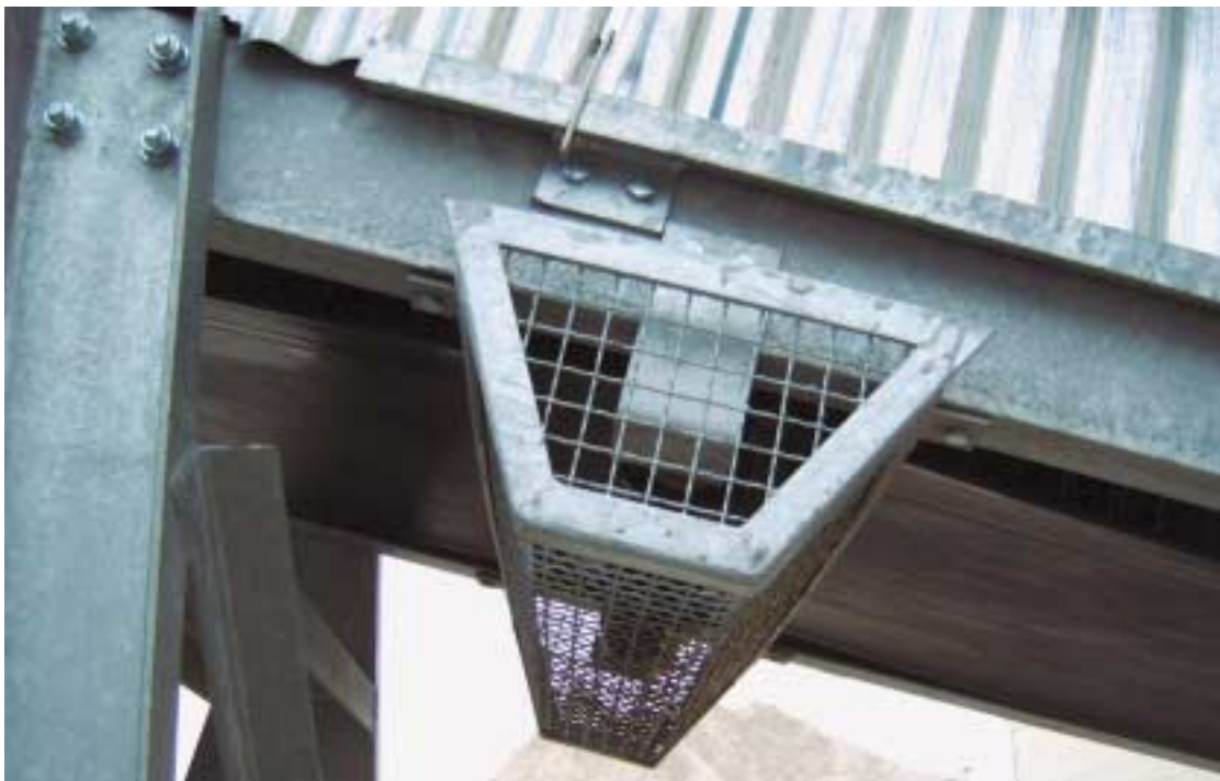
Abb. 13: Untergurttragrolle; Sicherung durch Schutzkorb
