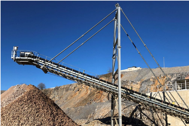
Abb. 24 Laufstege entlang des Gurtförderers und Bühnen am Bandkopf
