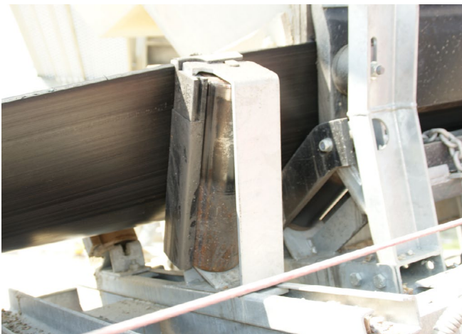
Abb. 20 Füllstück zum Schutz der Auflaufstelle an einer Muldungsrolle
