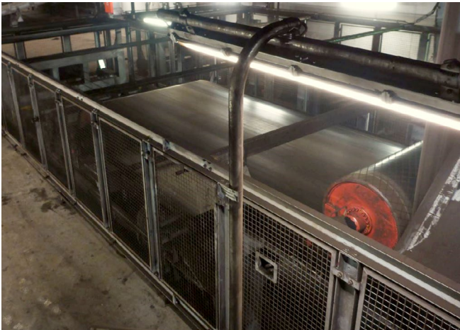
Abb. 16 Schutz der Auflaufstellen einer Spannstation durch trennende Schutzeinrichtung (Zaun mit elektrisch verriegelter Zugangstür mit Zuhaltung)
