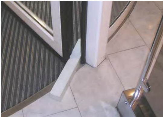
Abbildung 2: Fehltest! Der Styrodurkörper hat sich zwischen Haupt- und Gegenschließkante verankert.
