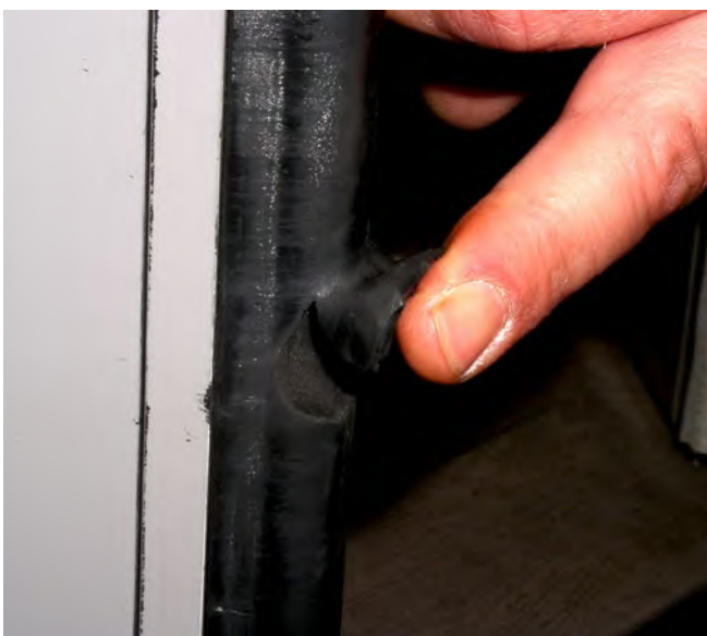
Abb. 7 Eingerissene Kontaktleiste Durch Beschädigung kann Schmutz und Feuchtigkeit eindringen, was die sichere Funktion der Kontaktleiste beeinträchtigt.
