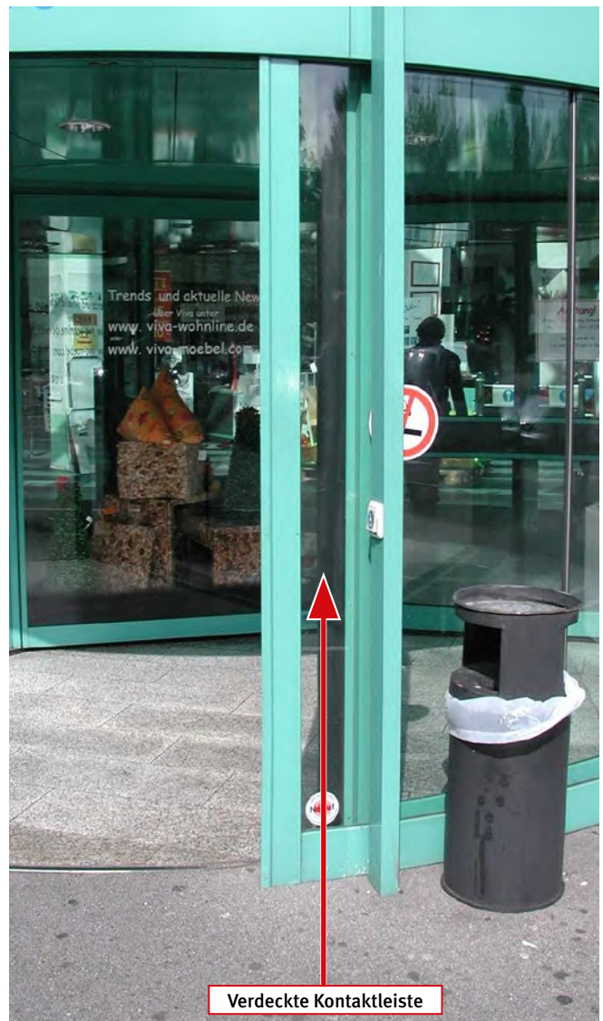
Abb. 8 Kontaktleiste ohne Wirkung Durch den vorstehenden Rahmen des Nachtverschlusses wird die dahinter liegende Kontaktleiste unwirksam gemacht. Die Hauptschließkante des beweglichen Türflügels würde eine Person oder ein Körperteil gegen den Rahmen des Nachtverschlusses drücken, ohne dass die Kontaktleiste berührt und ausgelöst werden kann.
