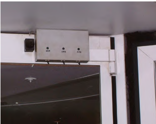
Abb. 10 Mögliche Manipulation von Schutzeinrichtungen Der Schaltkasten am Türflügel ermöglicht, dass Schutzeinrichtungen abgeschaltet werden können. Diese gefährliche Manipulationsmöglichkeit taucht dort auf, wo der Personendurchsatz zu Lasten der Sicherheit erhöht werden soll.
