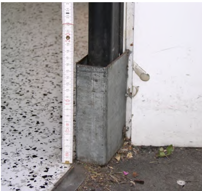
Abb. 6 Manipulation von Schutzeinrichtungen Unwirksame Kontaktleiste durch nachträglich angebrachtes U-Eisen, das die Kontaktleiste im Bodenbereich überdeckt. Ein Fuß würde gequetscht, die Kontaktleiste ist unwirksam.
