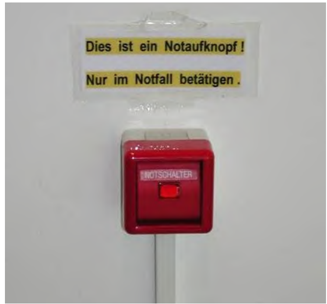
Abb. 11 Dies ist kein Not-Halt! Die Ausführung entspricht nicht den Anforderungen.
