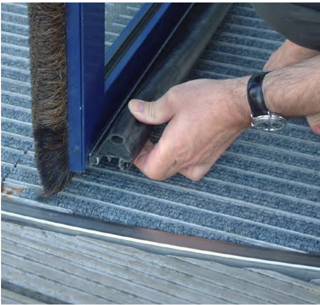
Abb. 9 Defekte Kontaktleistenbefestigung Die lose Befestigung der Kontaktleiste lässt ein präzises Schalten nicht zu. Ein Überfahren und Einziehen von Körperteilen unter den Türflügel ist möglich.
