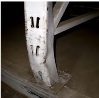
Abb. 12 Gerissene Schweißnaht an der Fußplatte der Stütze
