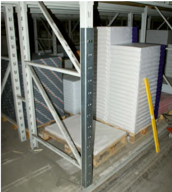
Abb. 18 Repariertes Regal: nach dem Richten wurde die Stütze mit einer Verstärkung versehen
