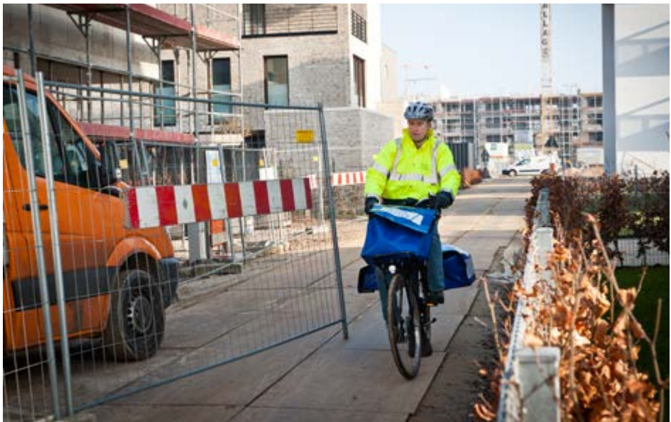
Abb. 3 Gefahr im Baustellenbereich
