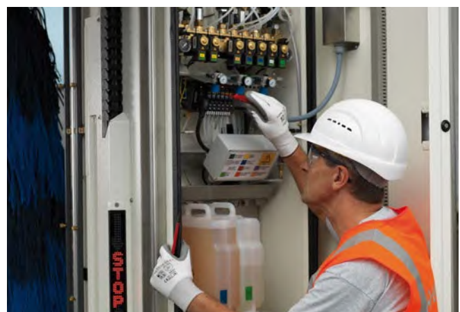
Abb. 14 Arbeiten an elektrischen Anlagen sind Elektrofachkräften vorbehalten.
