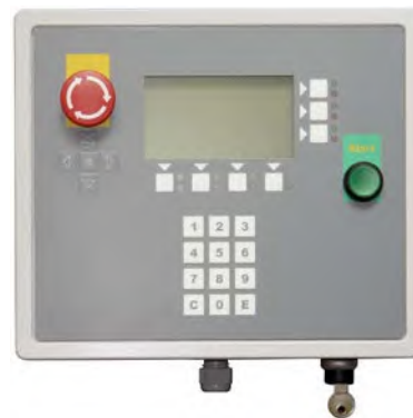
Abb. 19 Bei Betreten der Anlage z. B. für Reparaturen ist vorher der Hauptschalter zu betätigen und gegen Wiedereinschalten zu sichern, z. B. mittels abschließbarem Hauptschalter.
