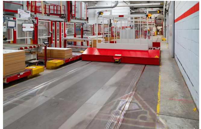
Abb. 46 Querverschiebewagen mit Laserscannern als Schutzeinrichtung
