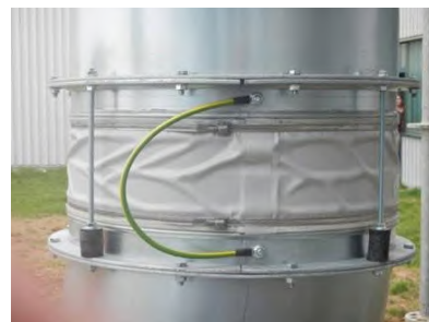
Abb. 31 Kompensator in einer Absauganlage
