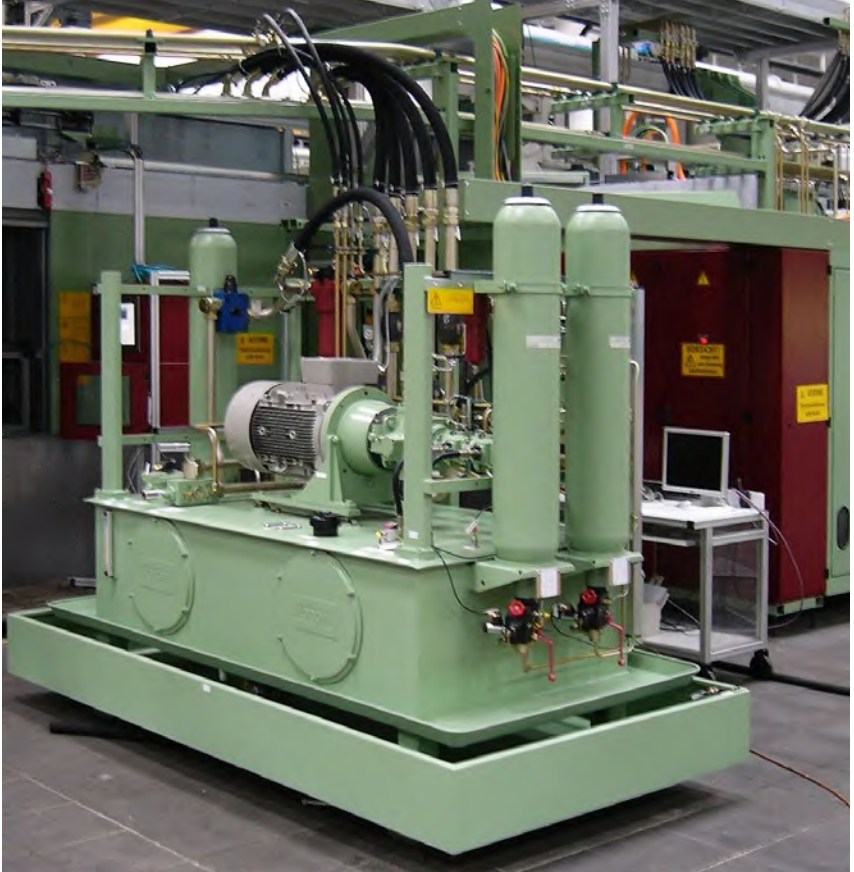
Abb. 24 Hydraulikaggregat an stationärer Produktionseinrichtung
