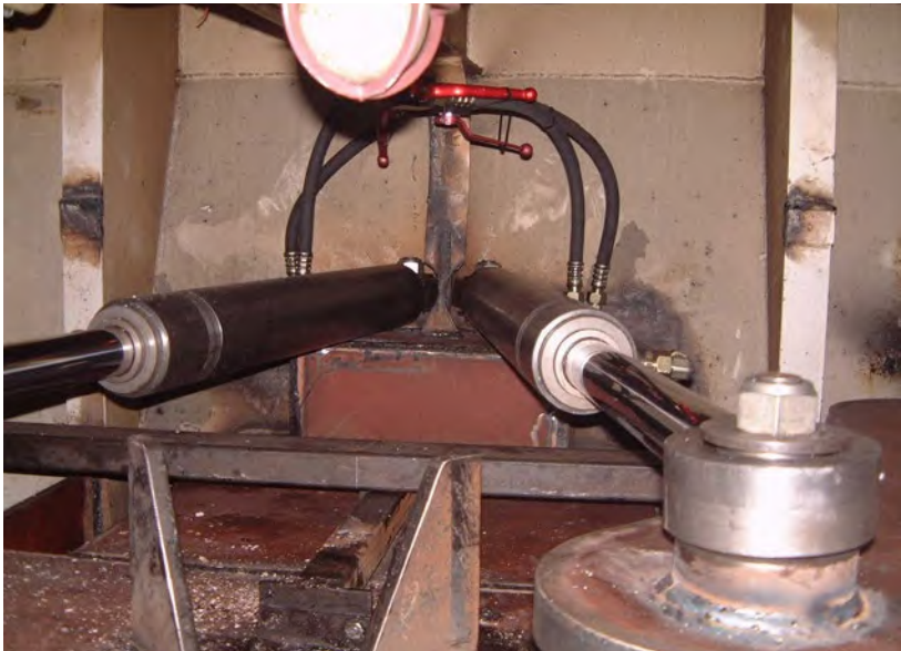
Abb. 43 Quetschgefahren an einer Ruderanlage
