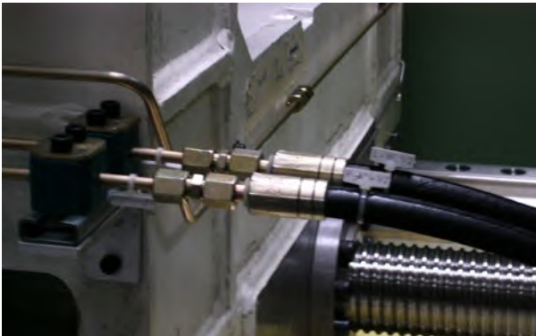
Abb. 26 Rohr- und schlauchseitige Kennzeichnungen
