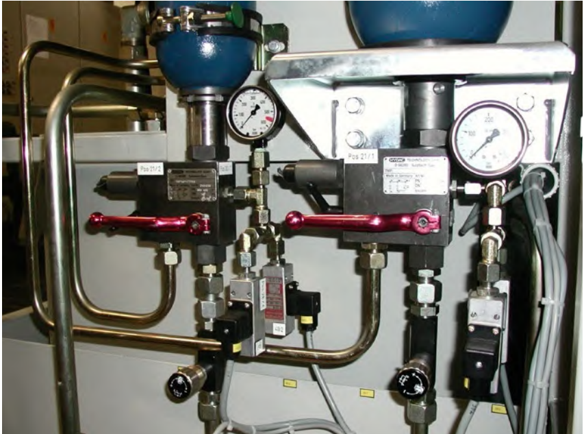
Abb. 25 Druckentlastete Hydrospeicher mit abgesperrten Druckleitungen
