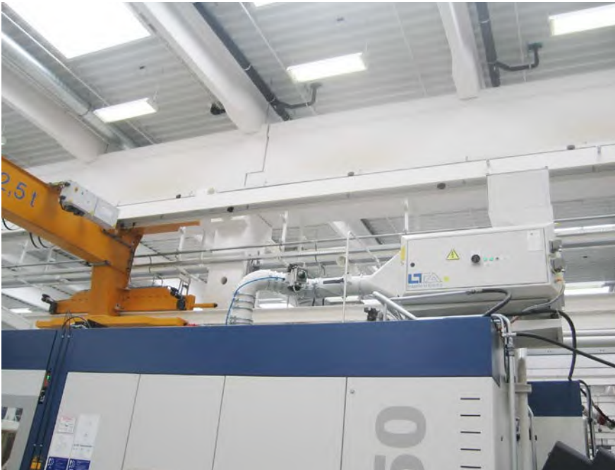
Abb. 8 Luftabsperklappe, Löschdüse und Strömungssensor
