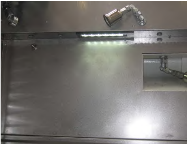
Abb. 11 Löschdüse und Wärmemelder/Temperatursensor im Maschineninnenraum
