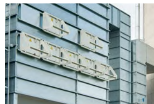
Druckentlastung über Explosionsklappen
