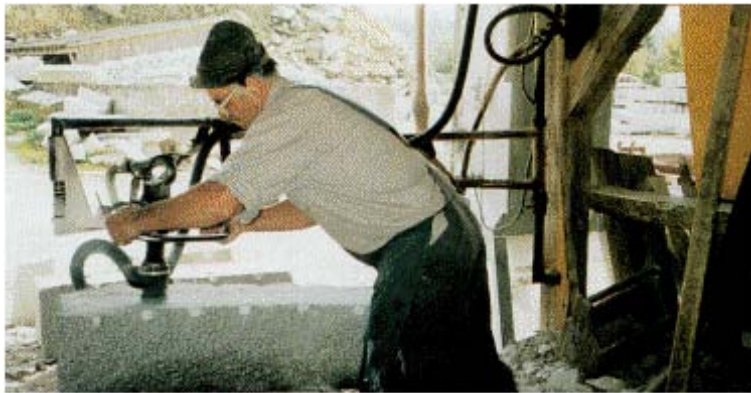
Abb. 23: Staubabsaugung direkt an der Bearbeitungsstelle
