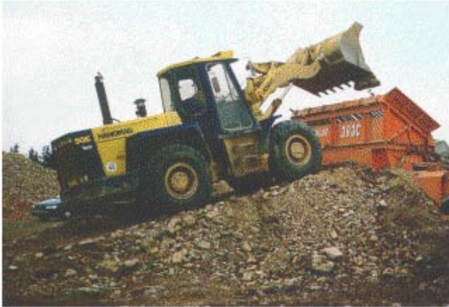
Abb. 12: Auffahrrampe ohne seitliche Schutzwälle
