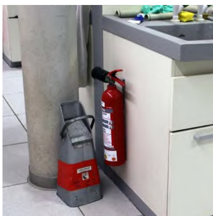
Abb. 6 Bereitgestellter Löschsand und Feuerlöscher
