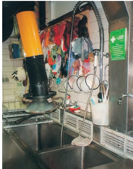
Abbildung 12a: Randabsaugung und flexible Punktabsaugung über einem Färbebecken (Landmann)
