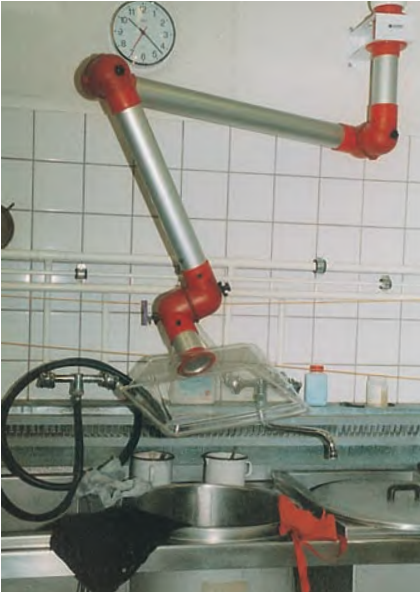
Abbildung 12b: Flexible Punktabsaugung über einem Färbebecken (Landmann)
