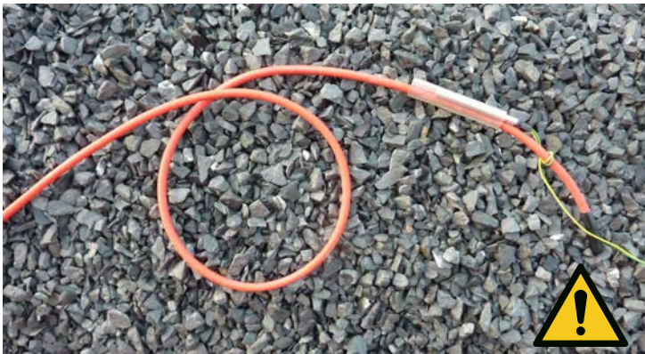
Abb. 24 Unzulässige Verlegung von Sprengschnur in einer Schlinge
