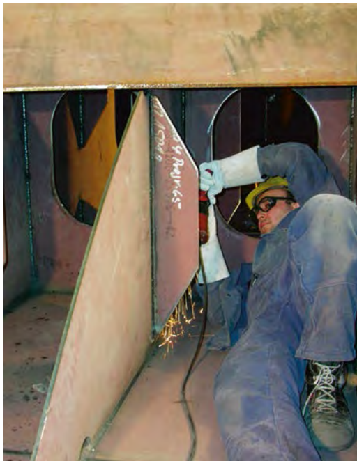
Abb. 9-1 Enger Raum mit erhöhter elektrischer Gefährdung
