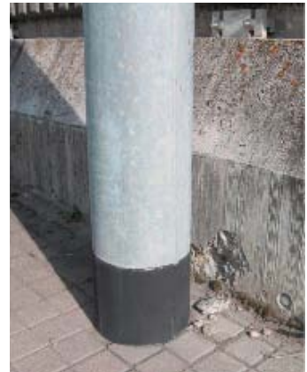
Abb. 5 Betonschaden durch Blitzentladung
