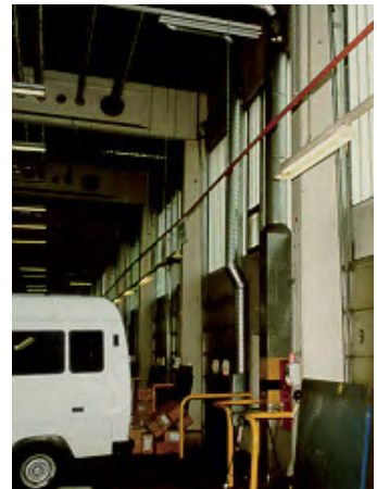
Bild 12b Abluft über Absaugrohre an der Seitenwand
