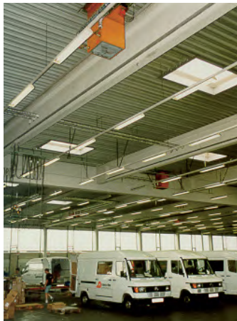
Bild 12a Zuluft im Deckenbereich
