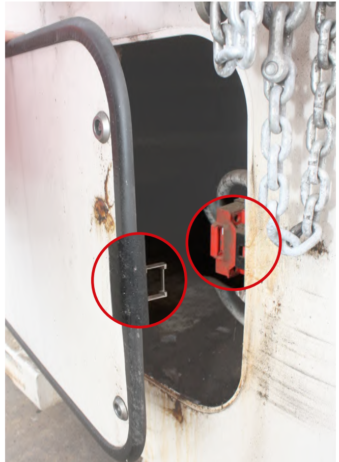
Abb. 11 Sicherheitsschalter an Zugang zur Wartung und Reinigung
