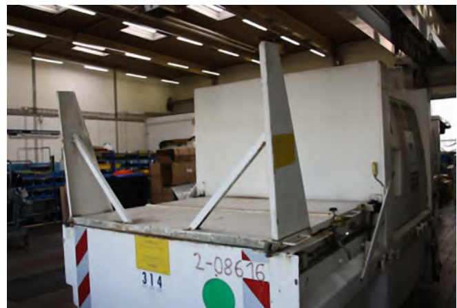
Abb. 8 Geschlossene Abdeckung der Presskammer mit angebrachter Sicherheitsbarriere für die Befüllung
