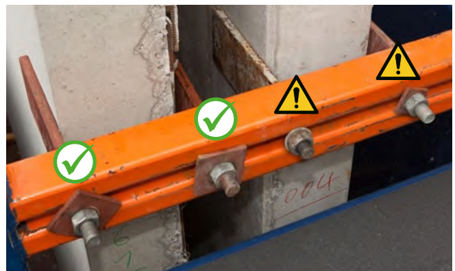
Abb. 18: Nur die beiden linken Arretierungselemente haben eine ausreichende Auflagefläche
