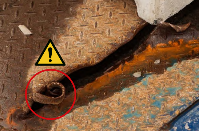
Abb. 27: Stich-, Schnitt- und Stolperstelle an aufgerissenem IP-Boden
