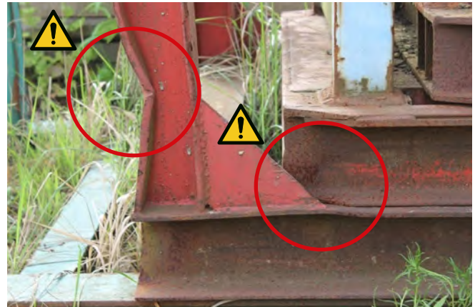
Abb. 25: Verbogene Stirnwand einer IP
