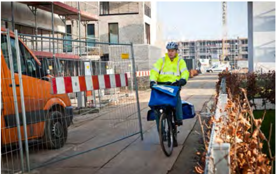
Abb. 3 Gefahr im Baustellenbereich
