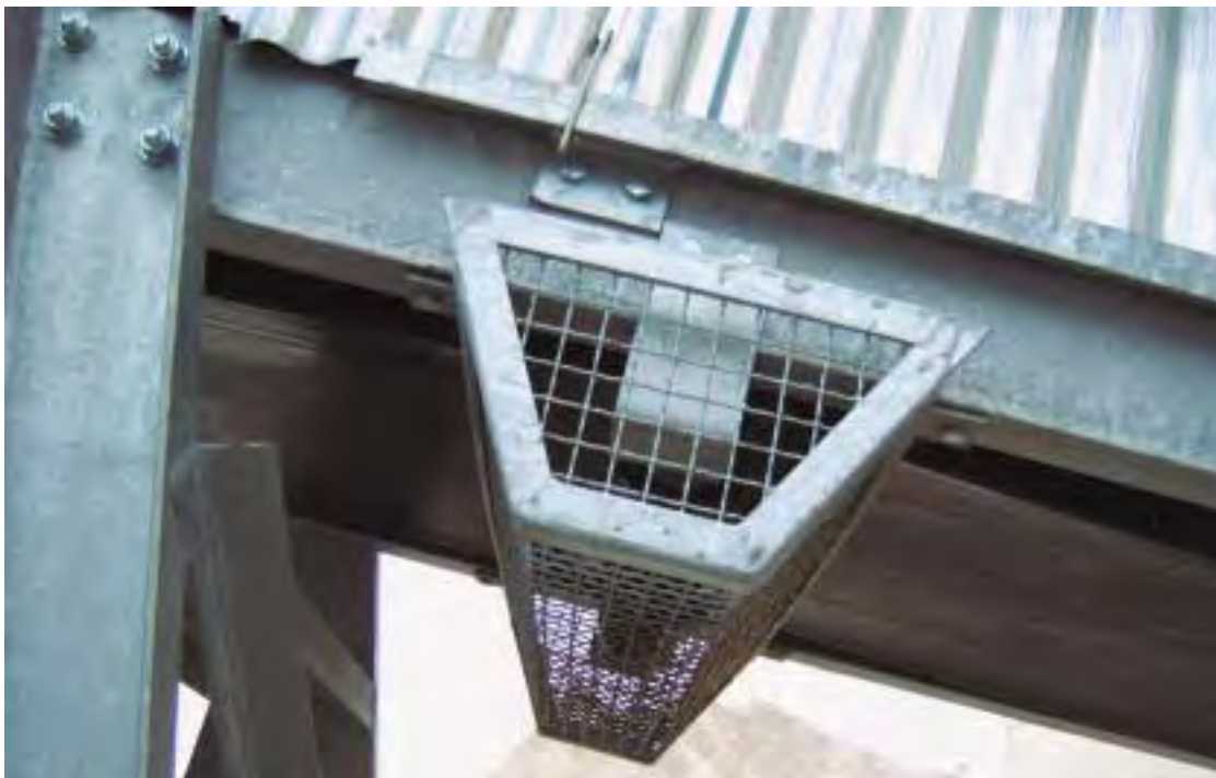
Abb. 13: Untergurttragrolle; Sicherung durch Schutzkorb
