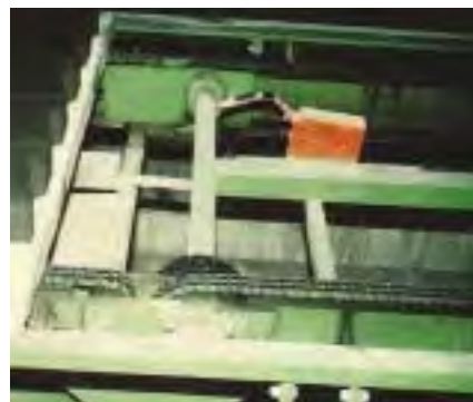
Abb. 35: Allseitige Verdeckung von Transportketten
