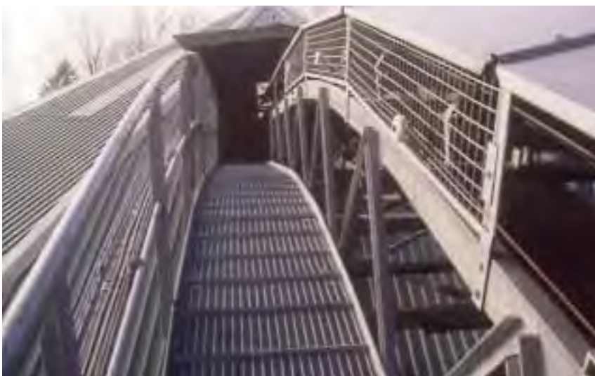
Abb. 15: Seitliches Schutzgitter an einer Bandabknickung
