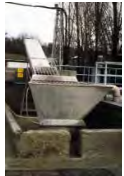
Abb. 42: Recycling-Anlage mit Austragsschnecke
