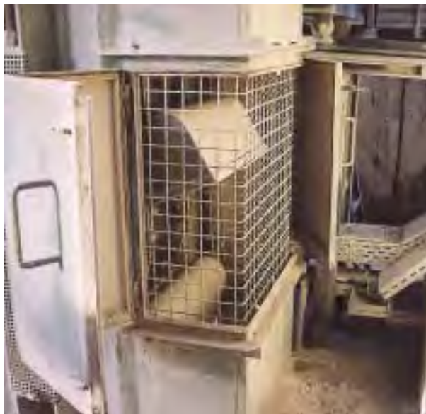
Abb. 39: Schutzgitter an einer Schauöffnung
