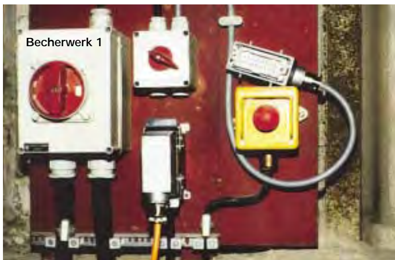
Abb. 40: Vor-Ort-Schalteinrichtung an einem Becherwerk
