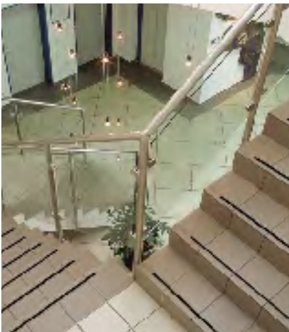
Stufenkante deutlich sichtbar – „Griffiger“ Handlauf
