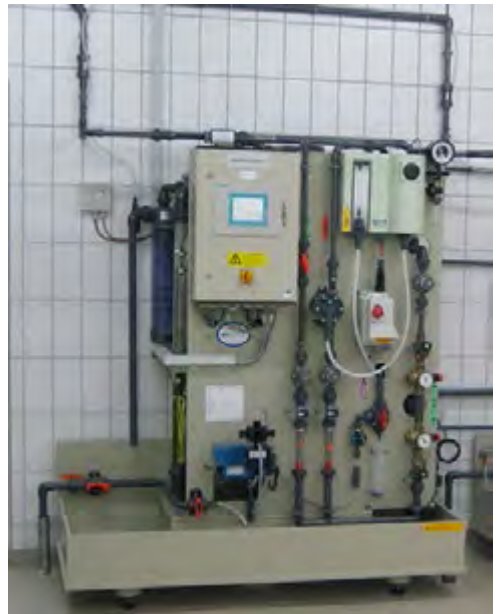
Abb. 7 Chlordioxidanlage nach dem Chlor-Natriumchlorit-Verfahren
