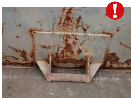
Abb. 17 Aufgeschweißtes Kip- plager entspricht nicht der DIN 30720-1
