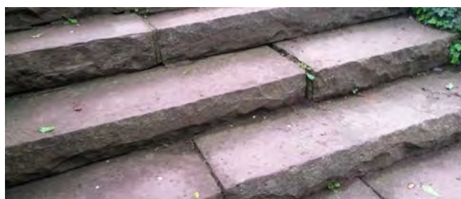
Abb. 16 Außentreppe mit erhöhtem Abrieb
