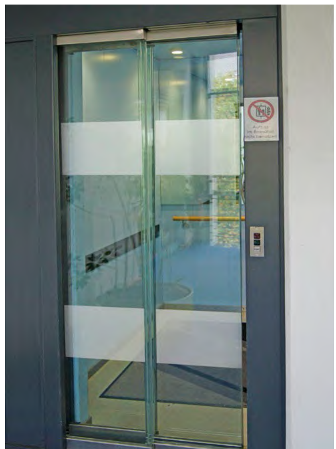
Abb. 1 Aufzug mit Markierungen auf Glasflächen
