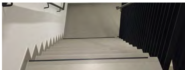
Abb. 14 Geflieste Treppe in Arbeitsstätten, unzureichend gekennzeichnet
